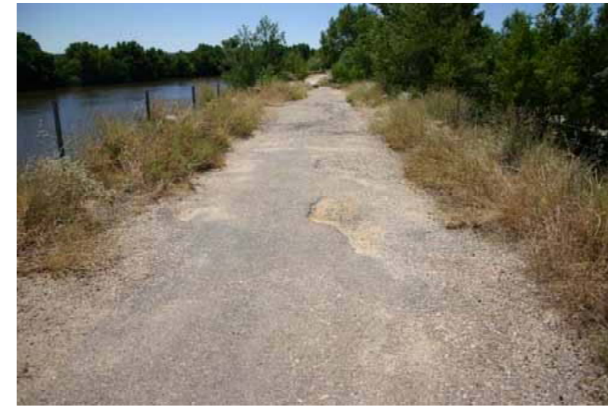
Estado de la calzada en la mitad sur del tramo principal.
