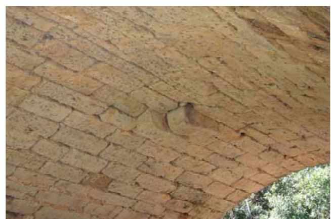
Dovelas desplazadas en bóveda de arco W.
