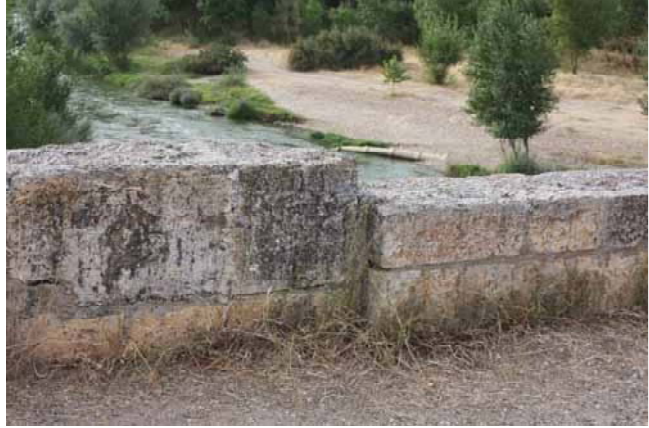
Estado de petos en mitad norte.
