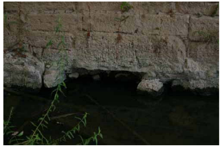
Entrada de agua en cepa entre arcos I-J.
