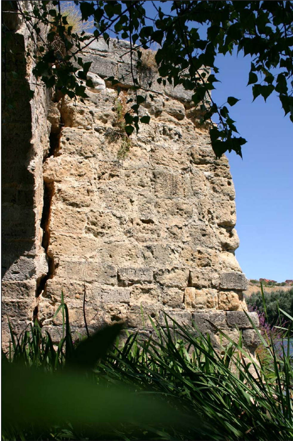
Foto N°23: Vista del saliente del muelle en el apoyo norte del primer arco del tramo de los Cinco Pilares, desde la parte baja del arco S. Se aprecia la separación del conjunto, por descalces en los cimientos producidos por el empuje del agua sobre el firme inferior.
