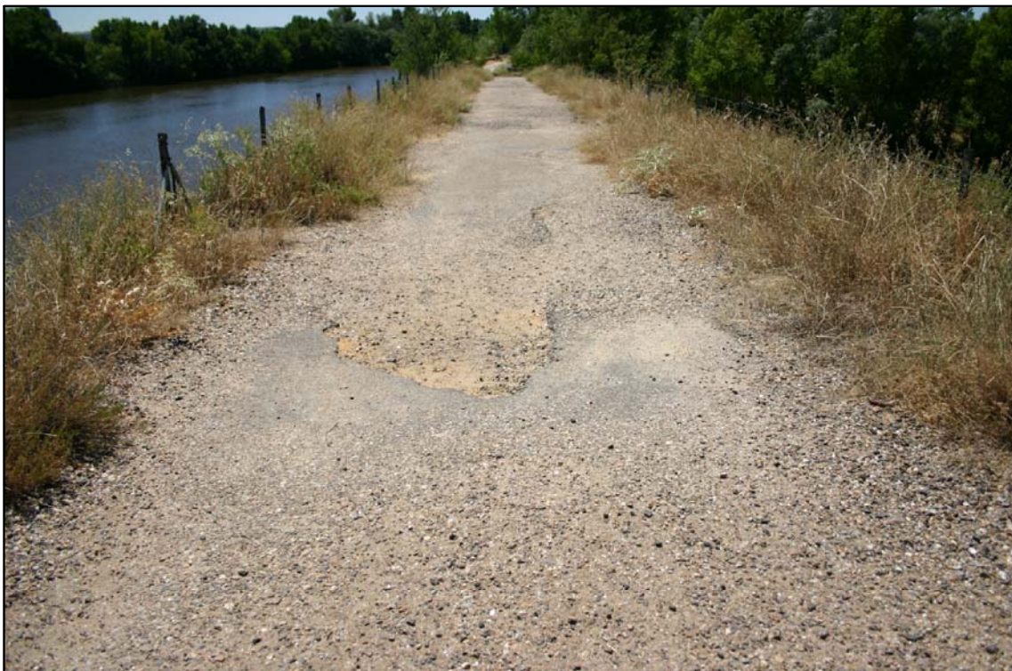
Foto Nº12: Vista del tablero del puente hacia el sur, en el tramo donde se han perdido los pretiles de fábrica.
