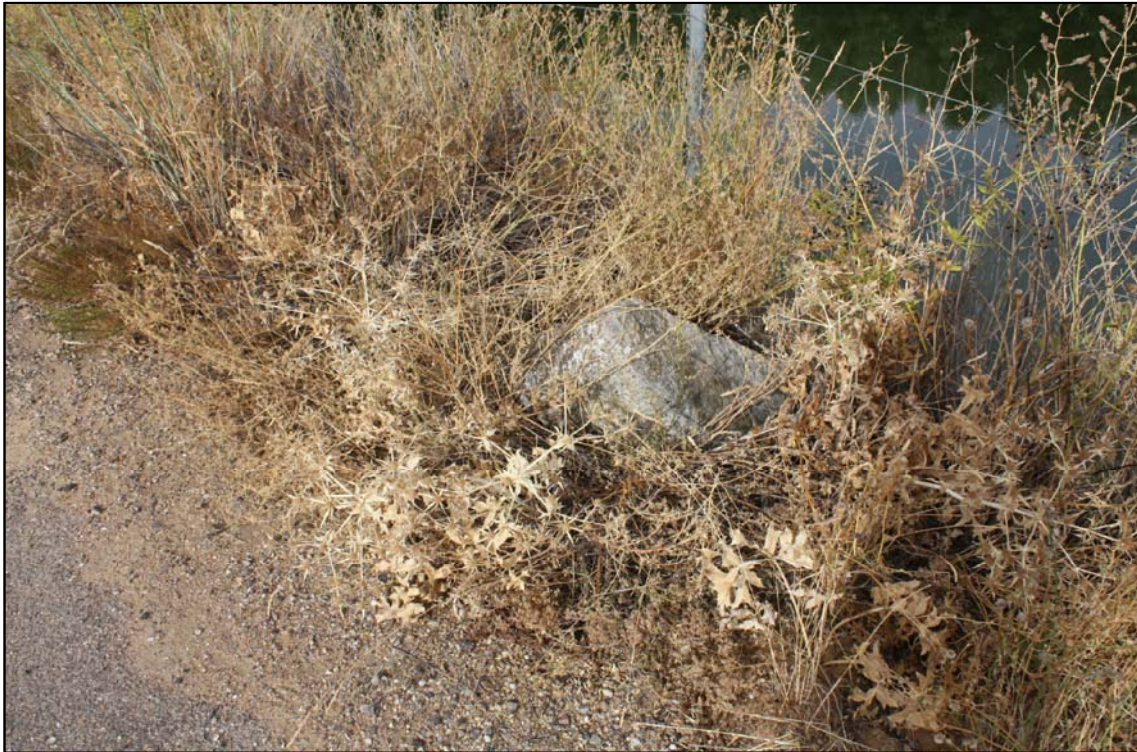
Foto Nº11: Detalle del estado de abandono de los pretiles en la mitad sur, donde han sido desmontados por actuaciones anteriores, siendo sustituidos por una protección indigna de postes y malla de alambre de simple torsión, medida provisional que se acabó convirtiendo en casi definitiva.
